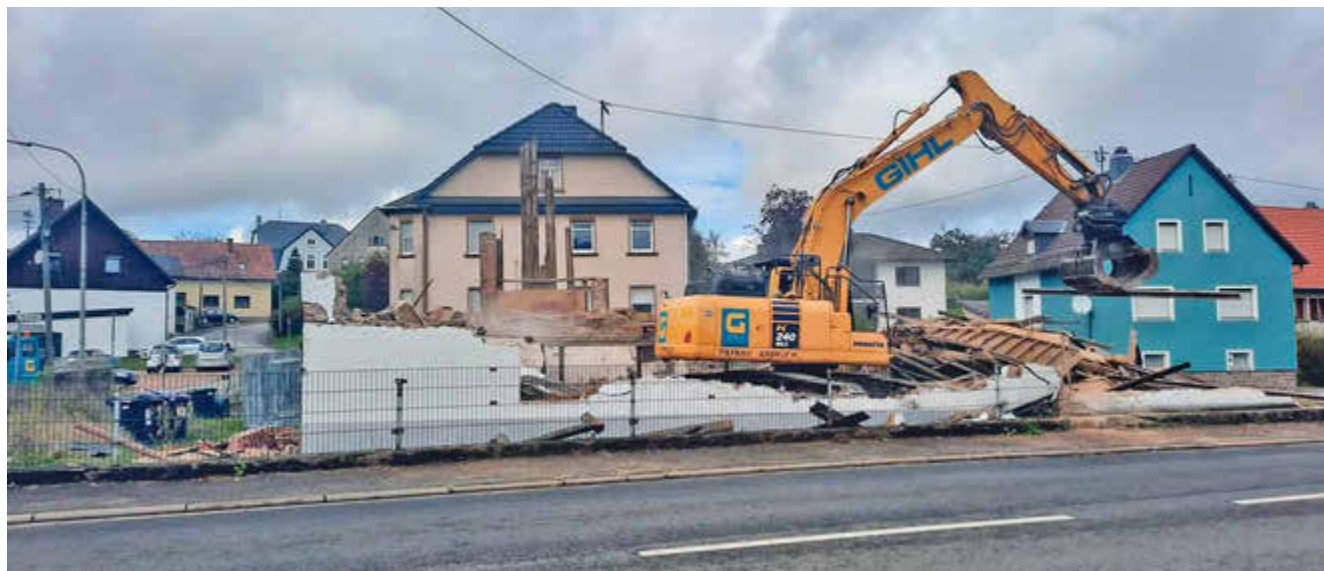
Abriss des ehemaligen Stallgebäudes an der Steinberger Straße in Walhausen / Foto: Gemeinde Nohfelden
