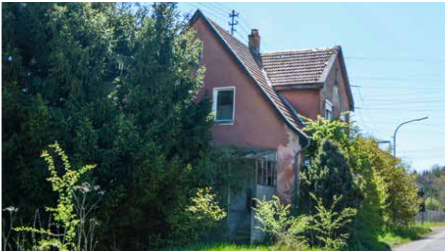
Leerstehendes Wohngebäude in der Löschbachstraße
